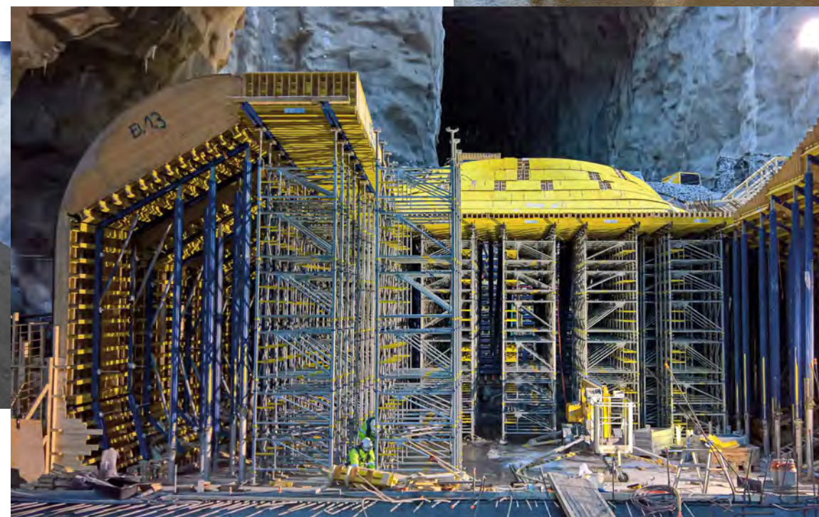
← Vamma Kraftwerk, Norwegen Eine der größten Wasserkraft-Erweiterungen Europas seit den 1980er-Jahren brauchte für das Saugrohr eine Sonderschalung vom Doka-Fertigservice. 1.500 m 3 Wasser pro Sekunde werden durch die 12 Turbinen des Kraftwerks fließen.
